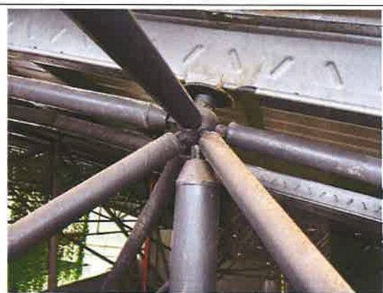
建筑现状完好、表面轻微锈蚀
