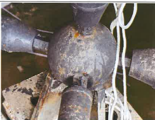
建筑现状完好、表面轻微锈蚀
