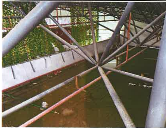
因屋面漏水导致下层积水
