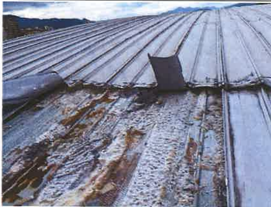
彩钢膜破损须修复、须清理屋面堆积物
